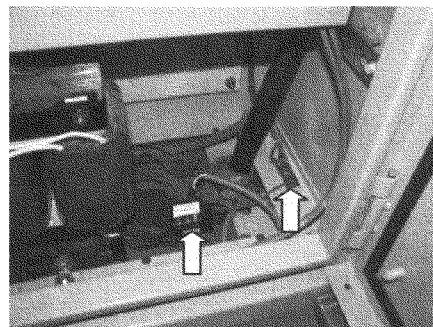
写真Ⅲ. 2. 2. 2-2 光学観測棟アース引込部（右矢印）と測定用端子（左矢印）
