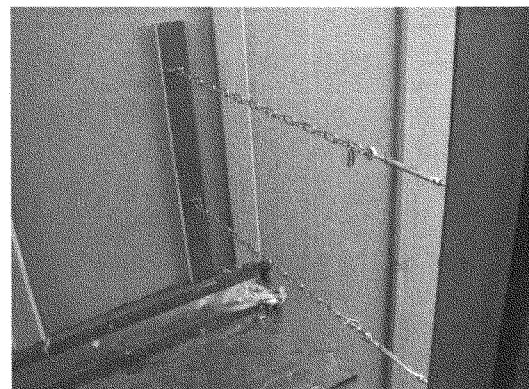
図Ⅲ.1.2.3-9 第1・2居住棟北側2階の非常口に設置した落下防止用の鎖
