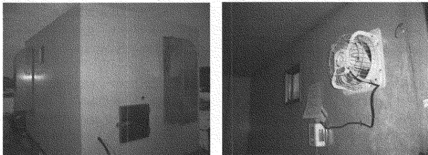
写真Ⅲ. 2. 5. 2-7 発電機小屋のダクト取り付け工事 (左：小屋外観、右：小屋内部)
