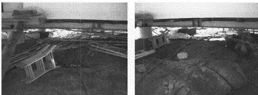
写真Ⅲ.2.2.1-5 第 2HF 小屋下に残置されていた過去の壊れたエレメント (左：処分前、右：処分後)
