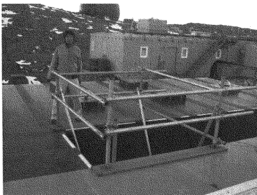
図Ⅲ.1.2.3-8 情報処理棟の屋上に設置した落下防止用の仮設の柵
