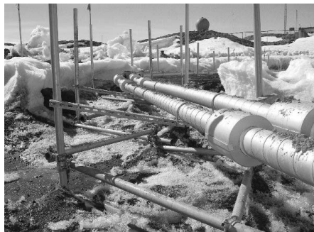
サポート破損状況(a)
