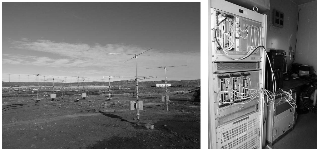
(a) アンテナと外部モジュール (左奥)
