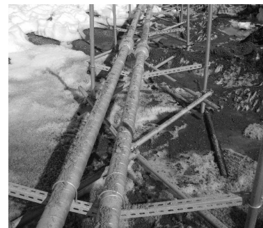
サポート破損状況(b)
