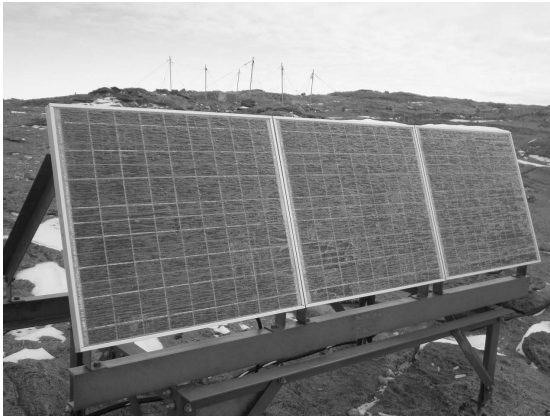
写真Ⅲ.3.2.4.1.6-1 損傷した太陽電池パネル
