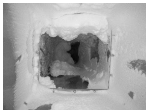
写真Ⅲ. 4. 1. 29-7 ダクト内閉塞状況
