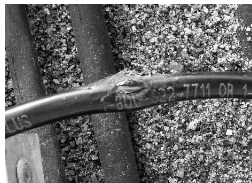
(b) 損傷箇所
