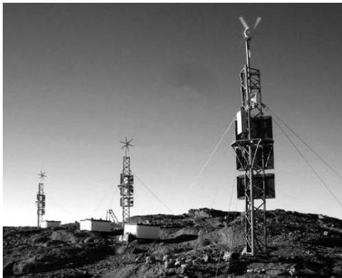
写真Ⅲ.3.2.4.1.6-1 ハイブリッド発電システム
