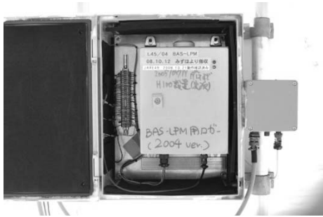
写真Ⅲ 7.6.9-2-6 ロガーボックス内部
