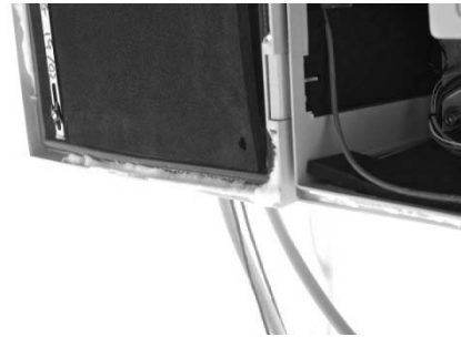
写真Ⅲ 7.6.9-2-7 ロガーボックスゴムパッキン
