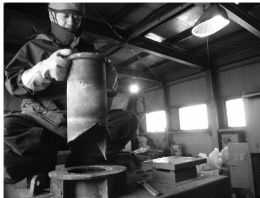
写真Ⅲ.4.5.7-1 焼却炉 内筒管破損状況
