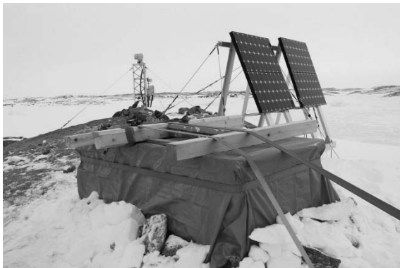
写真Ⅲ.4.7.8 岩島無線LAN設備(更新後)
