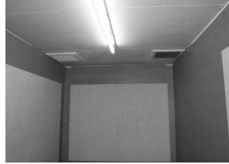
写真Ⅲ. 4. 8. 4-4 天井面換気扇
