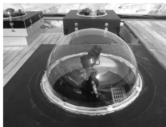
図Ⅲ.3.3.1-2 アクリルドームへの設置状況
