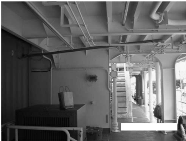
図5 コンテナ実験室への「しらせ」内空気取入用配管
