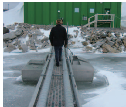
Photo 18 造水用池のフロート上に設置した配管 Photo 18 Water pipes set on a float in a pond.
