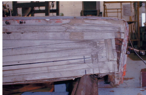
図7 屋根パネル支持点近傍の破壊状況(枠材節点のずれ)
