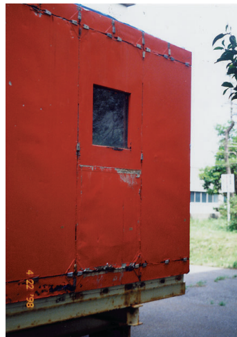
図18 建物風下，西側壁面の窓付パネルWF-2の状態。窓枠下部からの浸透水の影響で，外部鋼板，下地合板ともに最も劣化が進行していたパネルである。表面に見える合板は現地での補修跡である。
