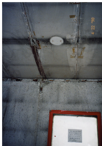
図 22 ラウンジの天井 屋根パネルの天井目地にガムテープを貼って漏水対策を試みた跡が見られた。接合金物 (コネクター) は健全で錆は見られない。
