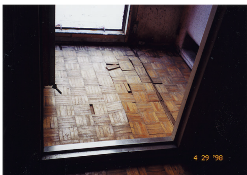
図 25 室内、床仕上げのパーケットフロア (2) 出入り口付近ではフローリングユニットの剥離、浮き上がりが見られた。浸透水の影響と思われる。
