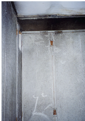
図20 暖房機室内の壁面の状態 表面の硬質木毛セメント板 が煤で黒く変色していた。
