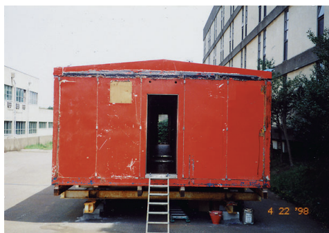
図 13 建物風上，北側壁面の損傷状況 図の左手前から斜めに風を受ける壁面だが，この妻壁には通路に続く前室が現地で取り付けられた（図 5 の配置図参照）。塗装剥離，鉄骨部品の錆の進行などは空気流の剥離点となる建物角部周辺に多く見られる。屋根パネル下部に残る分厚いコーキング跡は前室との接続のためである。出入口左上のパネル開口は原設計で換気設備があった箇所である。
