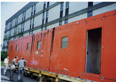
図 12 建物風上，東側壁面の損傷状況 壁面の白い斑点は外装鋼板の塗装剥離箇所である。図の建物中央付近には屋根防水のために観測隊が現地で施工したタールが流れ落ちた跡が残っている。また窓下に見えるのは現地で壁面を応急補修した合板である。
