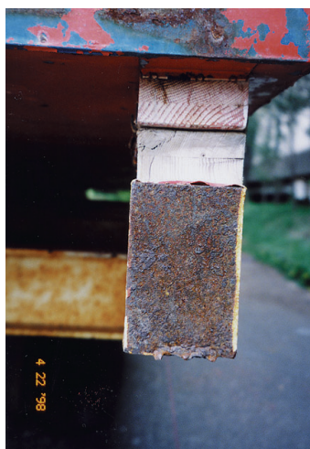
図 26 北側壁面コーナー、床下の結合材と鉄骨根太の端板の状況 風に直面する部分の塗装が完全に剥落していた。根太の端版では錆の進行による板厚減少が見られる。
