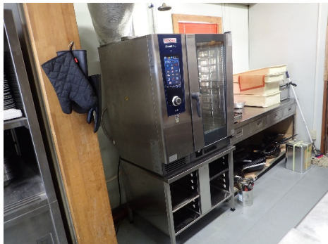
図 III.70 スチームコンベクション (交換後)
