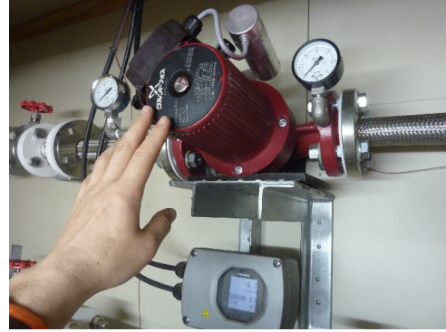
図 III.78 床暖房用ポンプ
