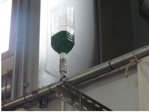
図 III.77 仮設膨張タンク
