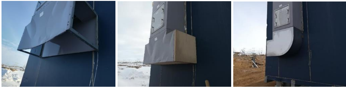
図 III.40 ダクト修理（左：変形し底板が外れている修理前、中：応急修理後、右：新品への交換後）
