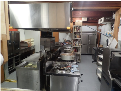
図 III.66 厨房機器とフード（手前）
