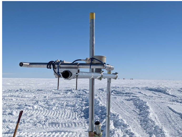
図 III.56 新たに設置した簡易積雪深計
