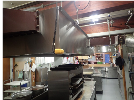
図 III.67 厨房機器とフード（奥）
