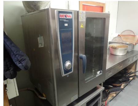
図 III.71 スチームコンベクション (交換前)
