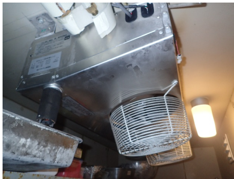
図 III.72 冷凍庫ドレンパン受け
