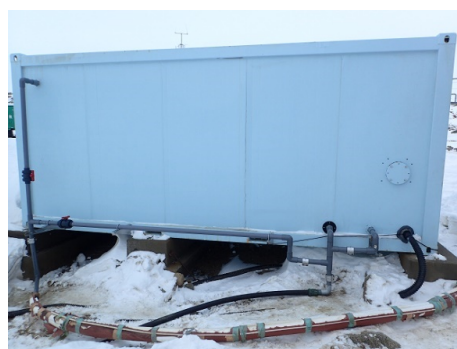
図 III.97 汚水処理装置
