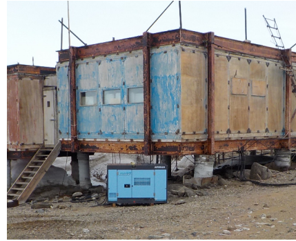
図 III.99 発電機屋外設置
