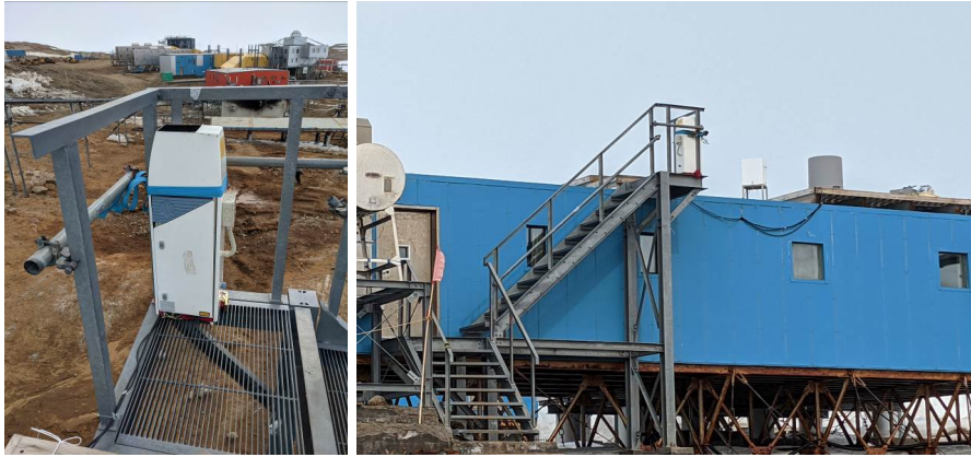
図 III.57 シーロメータ設置状況
