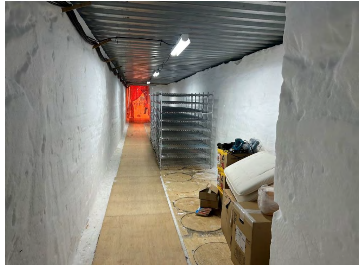
一時貯蔵庫屋内（完成時）
