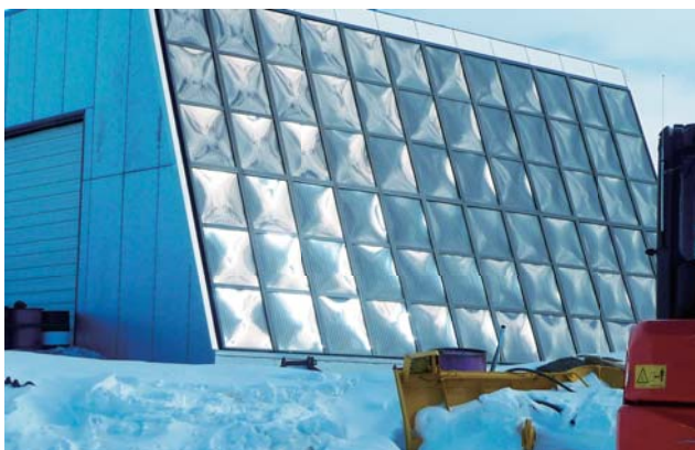
昭和基地の自然エネルギー棟に設置された太陽光集熱パネル
