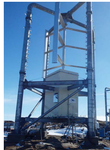
昭和基地に設置された20kw風力発電機
