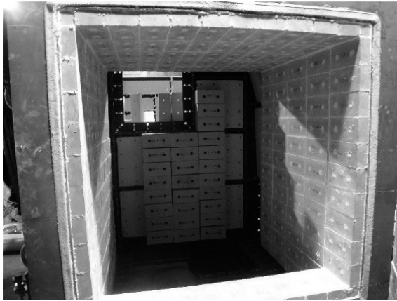
写真Ⅲ. 4. 5. 5-9 一次燃焼室 (5/31)
