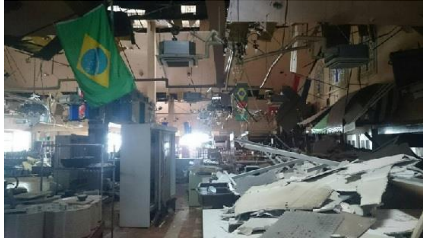
通常の建築物の被害状況
