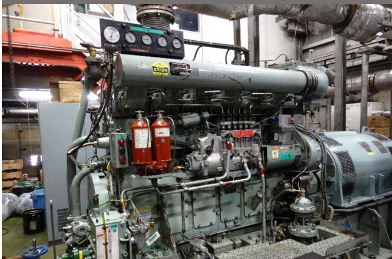
基地発電機：240kW × 2台 交互運転
