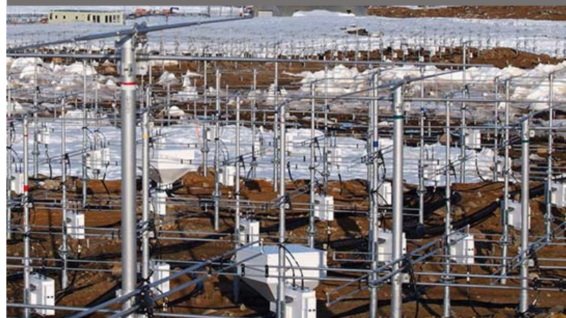
大型大気レーダー観測 (PANSY) 専用発電機：100kW × 2台 交互運転
