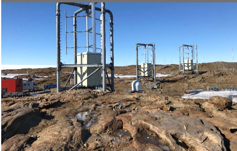
風力発電装置：20kW × 3台
