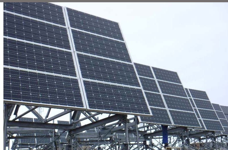
太陽光発電設備：55kW
