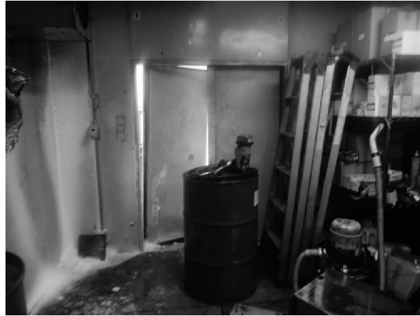
図Ⅲ.3.3.1.1-4 小型発電機小屋の海水側扉が外れた様子（2017年4月4日）
