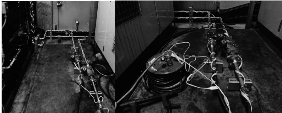
図Ⅲ.3.3.1.1-5 2017年8月28日 燃料配管の凍結防止用措置
