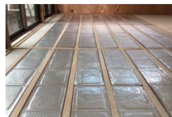
PCM設置状況
