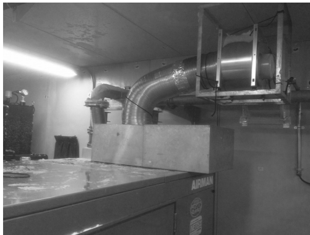
写真Ⅲ.3.2.1.1.1-1 発電機の集熱フード
