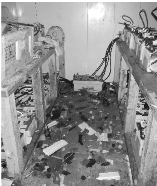
写真Ⅲ. 3.1.2.1.4-1 破裂した予備系蓄電池
