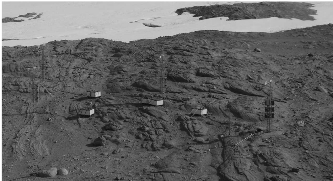
写真Ⅲ.3.1.2.1.4-2 増設した風力発電機4号機
